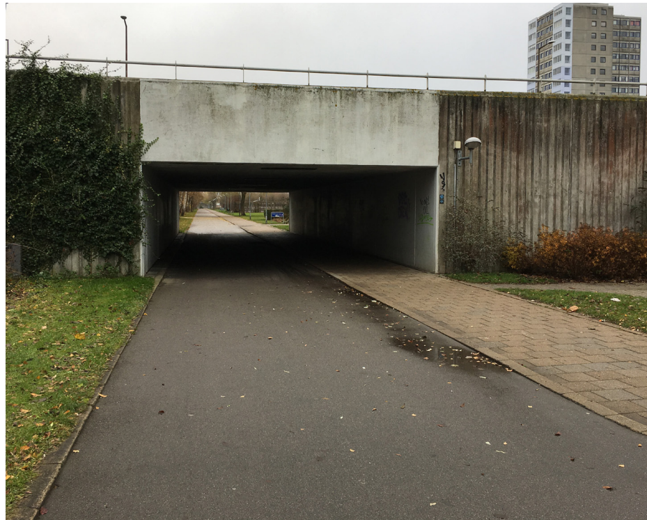
Hævede veje skaber utrygge tunneller
